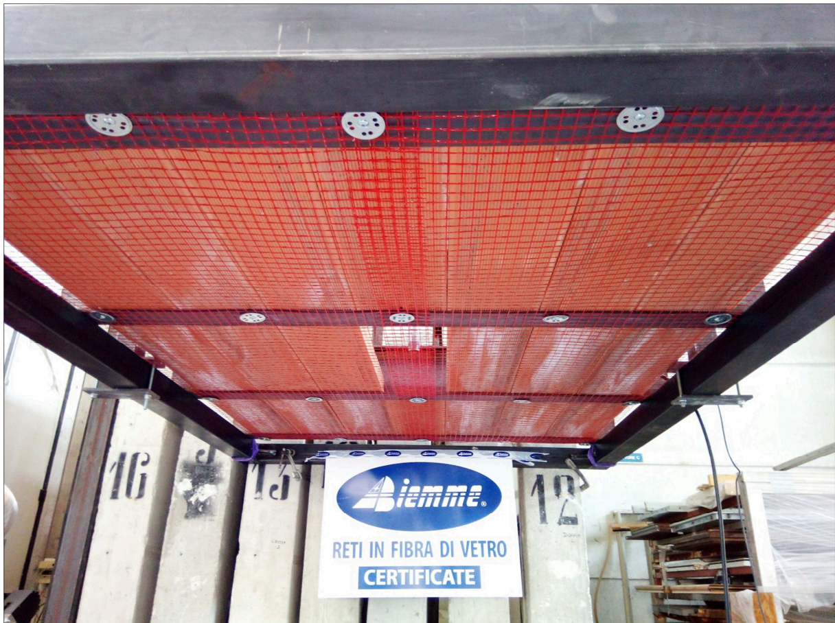
Fotografia dell'allestimento del sistema "S4"
