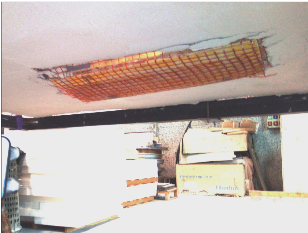
Fotografie della rottura della rete dopo la prova sul sistema "S6"
